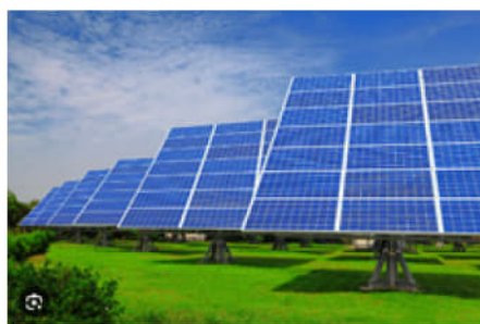
автономная фотоэлектростанция для электроснабжения;
